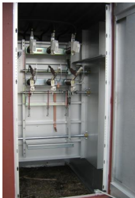
Figur 6. Infallsskydd demonterat ZT19/ZF19.
